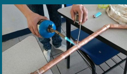
Fig. 2 Unión de tuberías
